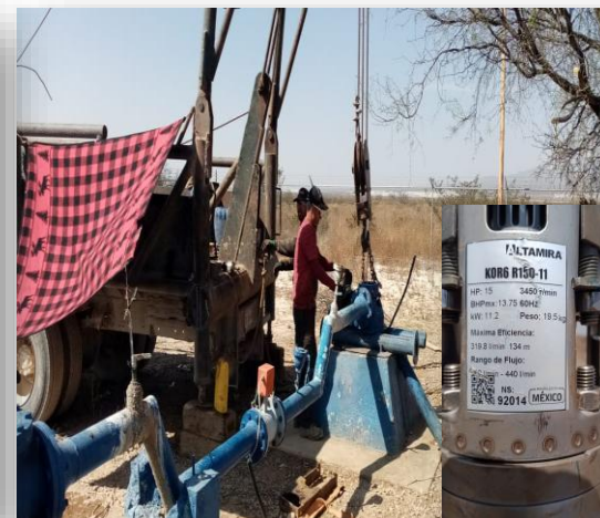
Bomba y motor sumergible de 15 hp, Pozo El Puente
