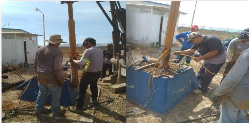
Bomba y motor sumergible de 25 hp, Pozo El Puente
