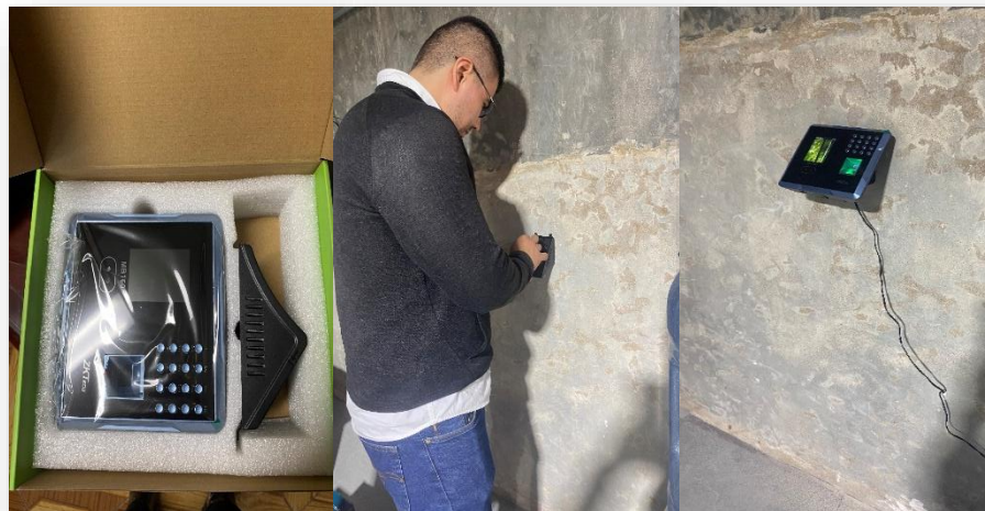
Instalación de reloj checador en oficinas nuevas Bustamante
