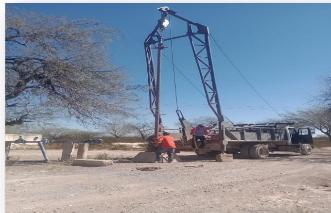
Bomba y motor sumergible de 40 hp Pozo San Isidro
