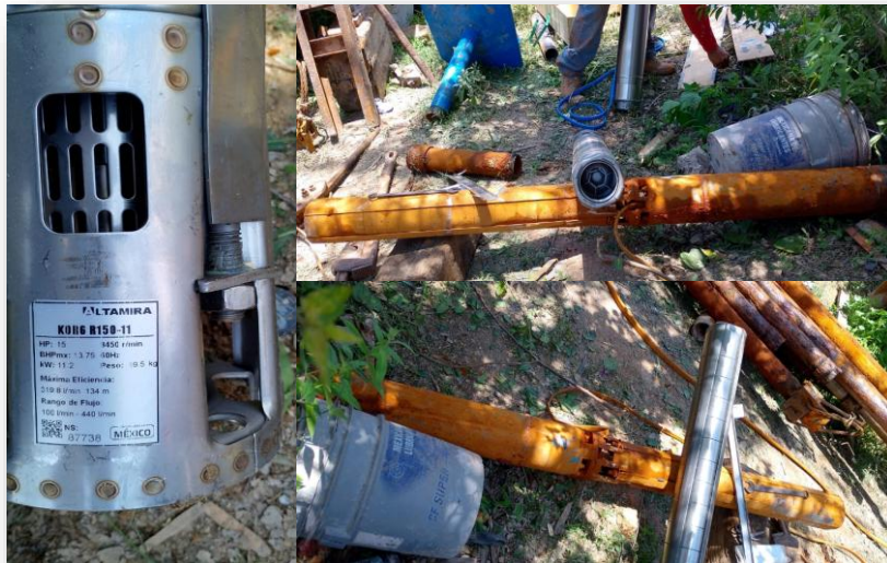
Bomba y motor sumergible de 15 hp, Pozo El Carmen
