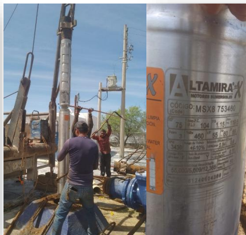
Bomba y motor sumergible de 75 hp para Pozo 16
