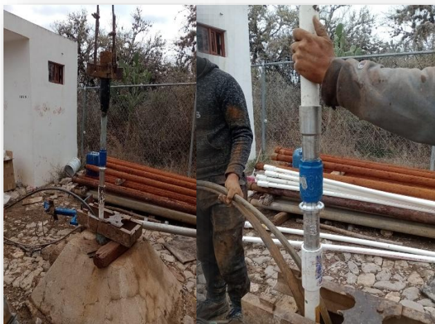
Bomba y motor sumergible de 5 hp, Pozo Caleros
