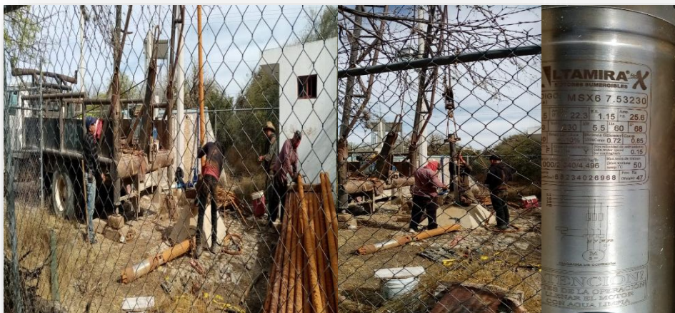
Bomba y motor sumergible de 7.5 hp Pozo Caleros
