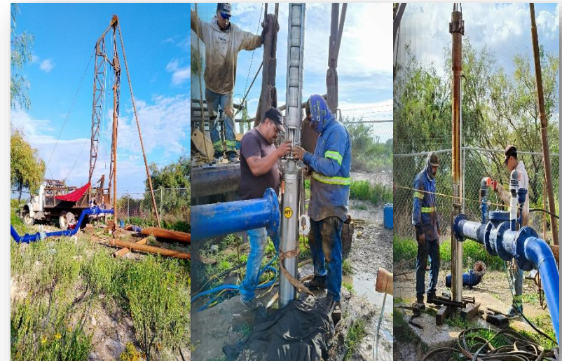
Bomba y motor sumergible de 60 hp, Pozo El Cedral
